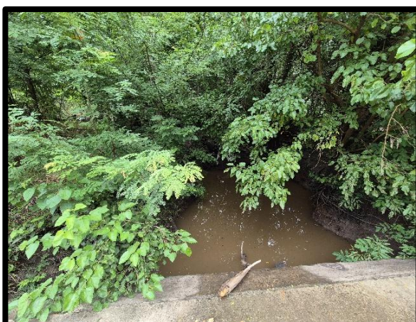
Figura 95 – Puente sobre arroyo Chañar, se observa gran cantidad de vegetación a los alrededores.
